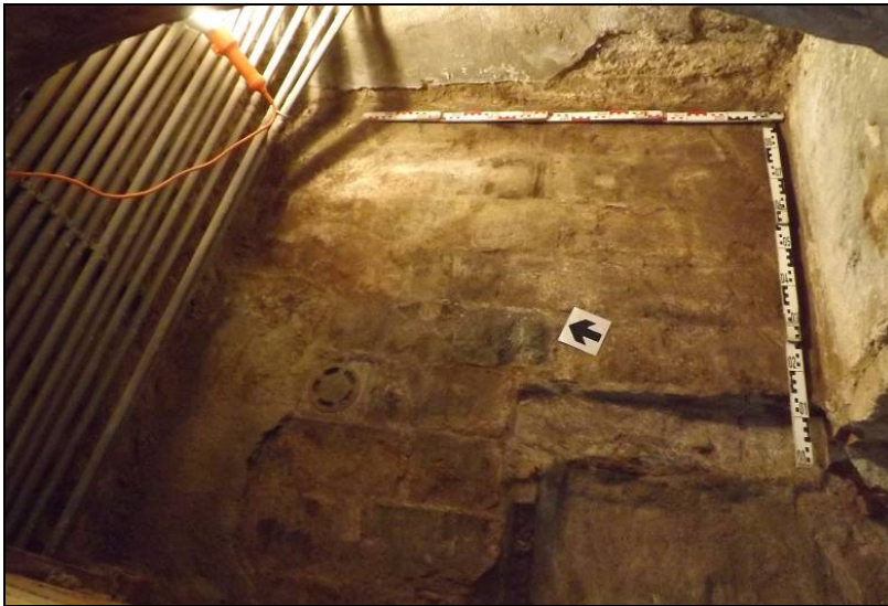
Vista del paviment de maons UE 108 i detall de l'embornal de ferro
